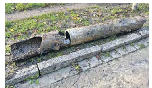
Gebrochenes Asbestzementrohr. Foto: MAWV
