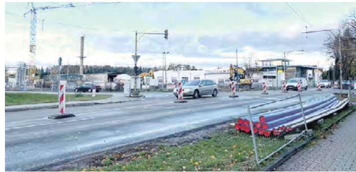
Mitte November liegen die blauen Trinkwasserleitungen an der Einmündung zum Kaufland bereit, alles läuft nach Plan. Foto: KMS/Straube
