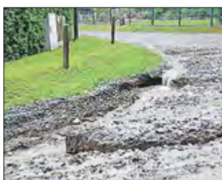
Die Kraft des Wassers – viele Straßen wurden unterspült.
