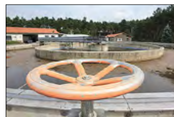
In den nächsten Jahren soll der Energieverbrauch der Kläranlage Alt Schadow (hier das Belebungsbecken mit integriertem Nachklärbecken) optimiert werden.
