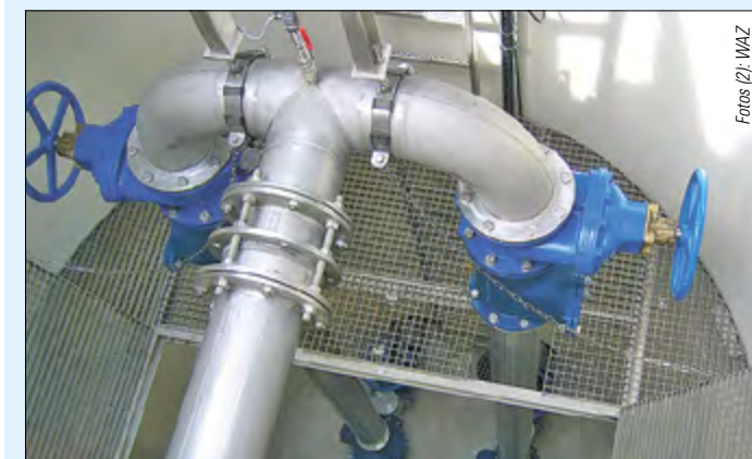
Im Hauptpumpwerk kommt das Schmutzwasser an und setzt seine Reise über Druckleitungen gen Waßmannsdorf fort.
