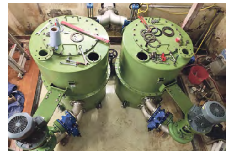
Eine spezielle Technik kommt im Pumpwerk „Golßen 2“ zur Anwendung: Hierbei werden die Pumpen durch die vorgelagerten Behälter vor Störstoffen geschützt, die Betriebssicherheit steigt.
