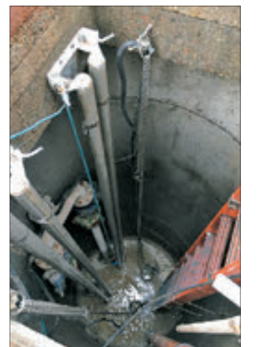
Die gesamte Ausrüstung des Pumpwerkes in der Ahrensdorfer Straße wurde durch neue, an die geänderten Leistungsanforderungen angepasste Technik ersetzt. Foto: WARL
