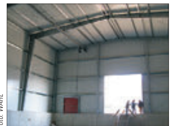
In dieser Halle können zwei 1.000m 3 fassende Tanks stehen.
