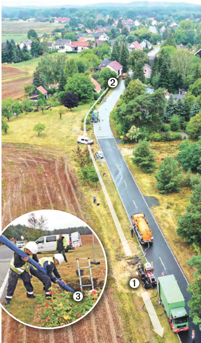
Der Horizontal-Spülbohrer ① zieht die Leitung von Limsdorf ② kommend unterirdisch ein. Kollegen der Firma SPIE beim „Einfädeln“ des 11 cm starken PE-Trinkwasserrohres in der Startgrube ③.
