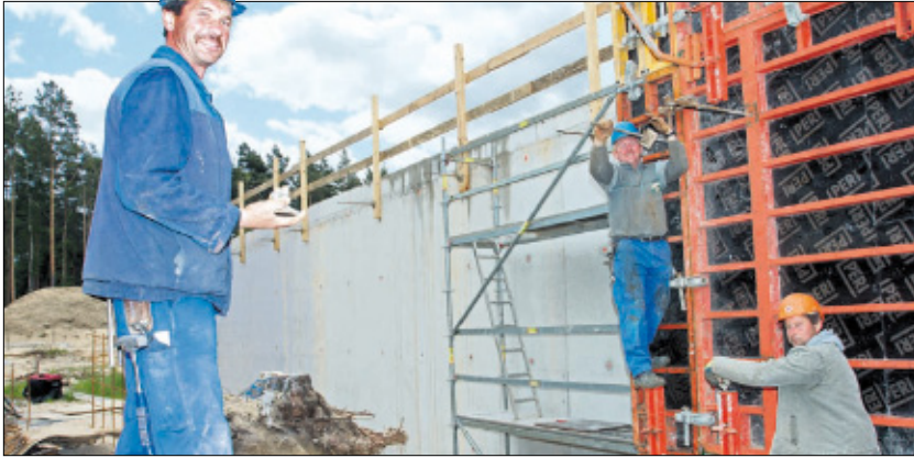
Frank Westhaus, Thomas Nowiki und Polier Sören Fischer (v.l.), Mitarbeiter des Baubetriebes WBB, beim „Verschalen“ der Behälterwände.
