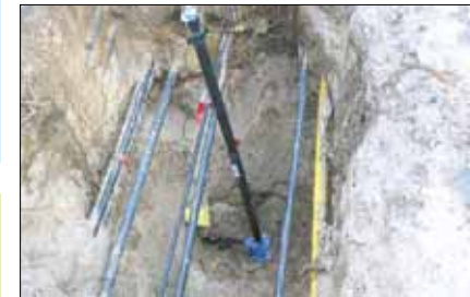
Da bleibt wenig Raum für die Verlegung neuer Leitungen.
