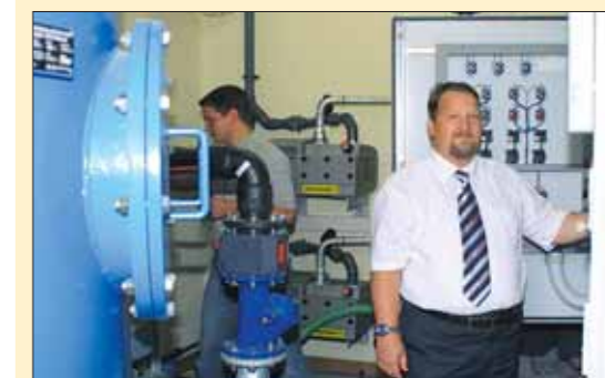
WARL-Verbandsvorsteher Hans-Reiner Aethner (r.) und Projektgenieur René Staffen (l.) prüfen das technische Innenleben der neuen Vakuumstation Christinendorf.
