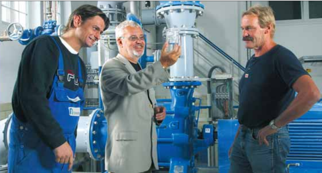
Mit kritischen Augen geprüft und für gut befunden. MAWW-Verbandsvorsteher Peter Albrecht (m.), Wasserwerksmeister Holger Radloff (r.) und Maschinist Christian Zwanzig von der DNWAB sind sich darin einig, dass die Qualität des Trinkwassers aus dem frisch sanierten Werk Eichwalde höchsten Ansprüchen gerecht wird.
