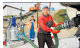
Die neue Fäkalannahmestation des KMS in Zossen ging im Frühjahr dieses Jahres in Betrieb.
