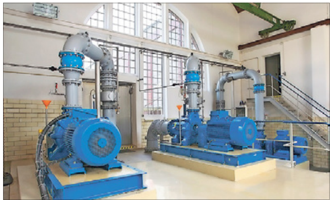
Pumpenhalle im Wasserwerk Eichwalde, das seit Juli 2002 nach erfolgreicher Umweltprüfung gemäß DIN EN ISO 14001 zertifiziert ist.
