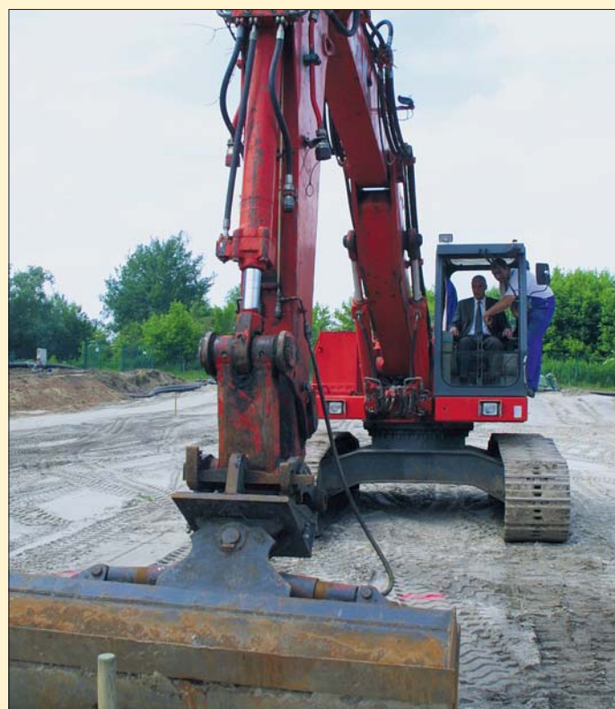
Minister Birtbler gab den Startschuss für die neue Anlage.
