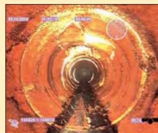
Dieses Bild zeigt Risse im Kanal (helle Stellen oben). Die Leitung muss saniert werden.
