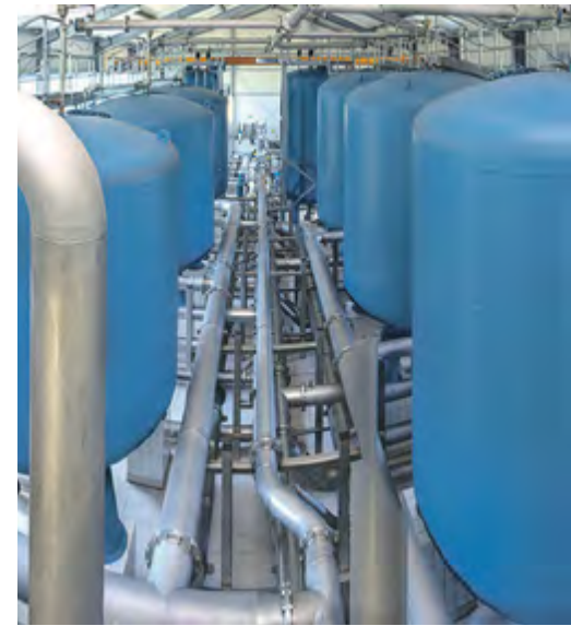
Die DNWAB-Fachkräfte haben hochmoderne Technik zur Verfügung – wie hier im Wasserwerk Groß Schulzendorf.
