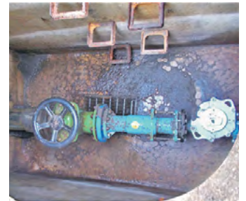
Einer von zwei Druckminderern, die im Schacht für den richtigen Druck sorgen werden.
