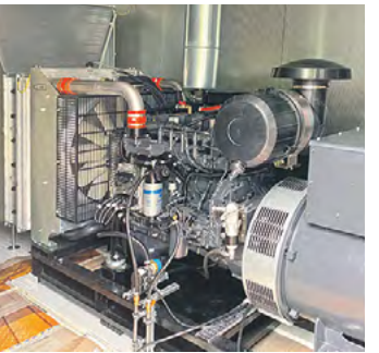
Moderne Technik für den Ernstfall – das neue Notstromaggregat des KMS im Wasserwerk Rangsdorf.
