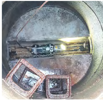
Nur so ist die selbstfahrende schwenkbare Kamera in der Lage, Schäden und deren Größe zu entdecken.
